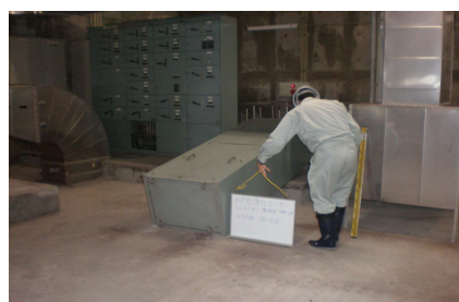
水戸市浄化センター制御盤の転倒
