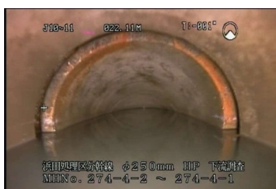
管路内部の滞水
