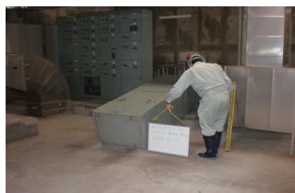
水戸市浄化センター制御盤の転倒
