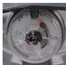
× 指示圧力計の損傷
