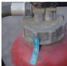
× キャップの劣化
