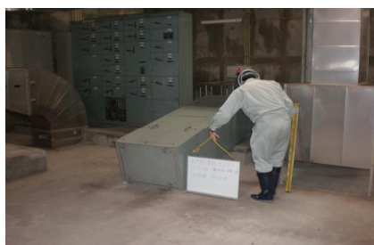
水戸市浄化センター制御盤の転倒
