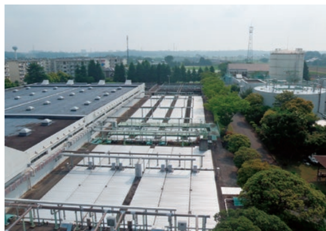
水戸市浄化センター
