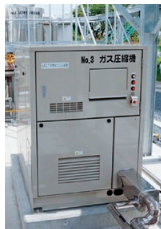
②ガス圧縮装置
