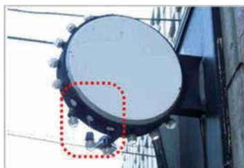
危険な屋外広告物の例
