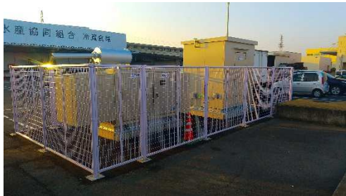
（揚水、フォークリフト充電用）
