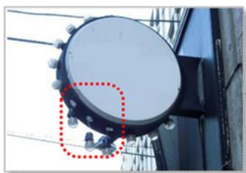
危険な屋外広告物の例
