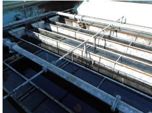
図 4-8 開江浄水場ろ過池腐食進行状況
