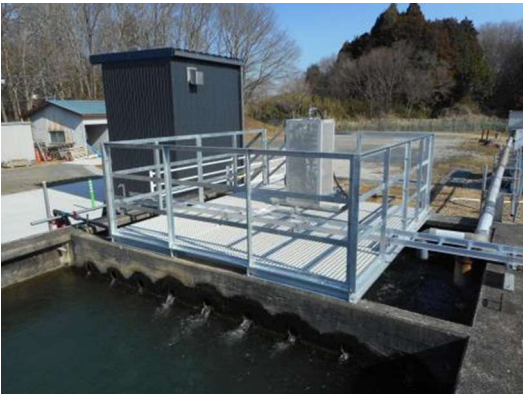
図 4-25 開江浄水場 粉末活性炭注入設備設置状況
