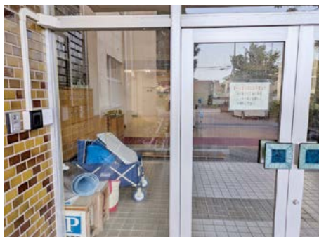
オートロック及びドアホンが整備された学校玄関
