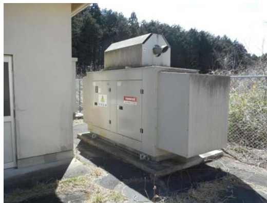
図 4 -16 内原配水場高区増圧ポンプ 非常用自家発電設備設置状況
