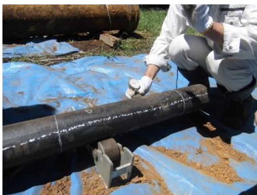
図 3-5 腐食深さ測定状況
