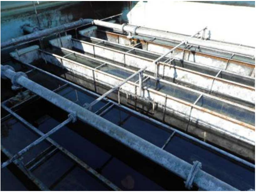
図 4-8 開江浄水場ろ過池腐食進行状況
