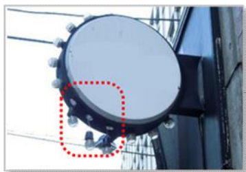
危険な屋外広告物の例
