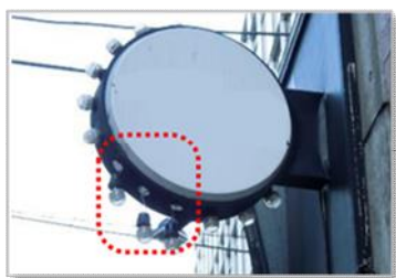
危険な屋外広告物の例
