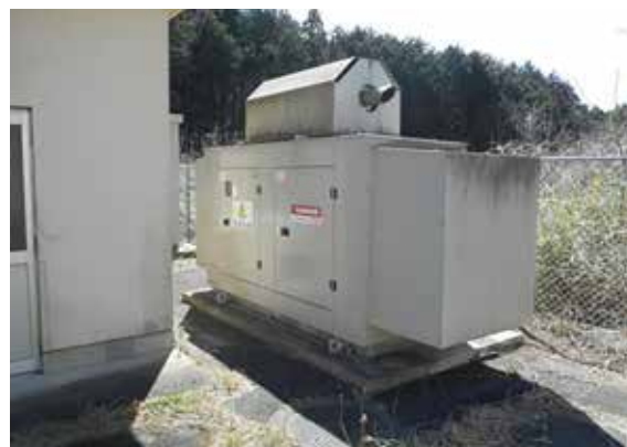
図4-2-5 内原配水場高区増圧ポンプ 非常用自家発電設備
