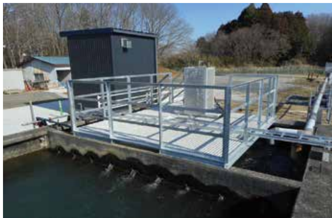
図4-1-5 活性炭注入設備
