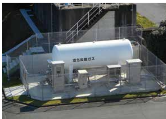
図4-1-3 炭酸ガス注入設備（楮川浄水場）
