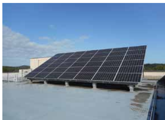
図4-6-2 楮川浄水場管理棟屋上の太陽光発電装置
