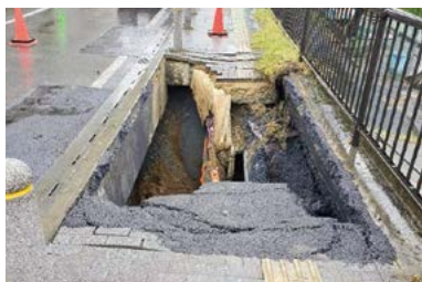
陥没事故の現場(大工町)
