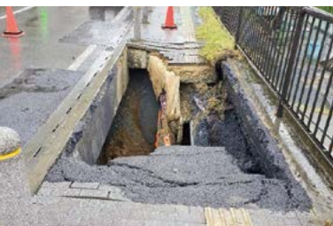
陥没事故の現場(大工町)
