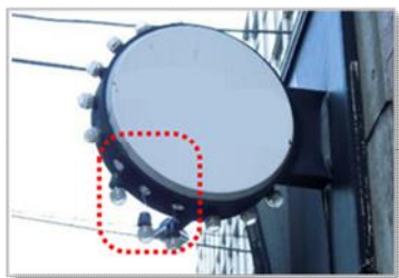
危険な屋外広告物の例
