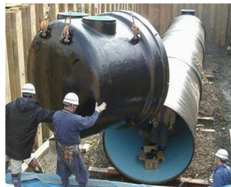
図 4-18 耐震型循環式飲料水貯水槽設置状況
