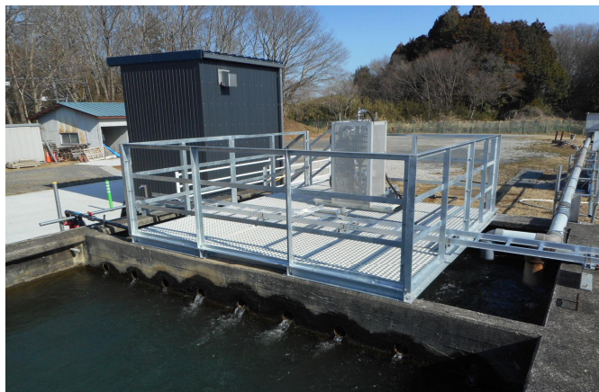
図 4-1-5 活性炭注入設備
