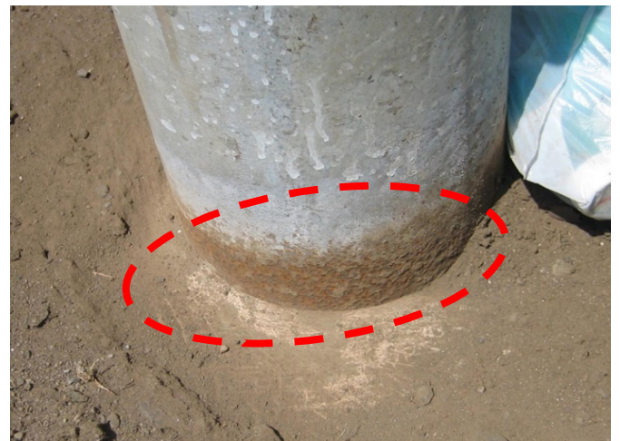
【路面境界部腐食】
