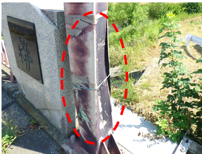
【支柱変形・傾斜】
