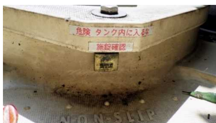
図 16 タンク開口部の施錠
