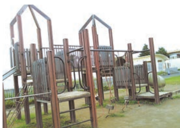
腐食が見られる新荘小の遊具
