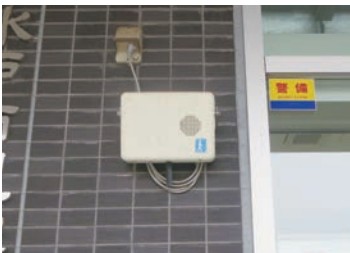
市民センターに設置している音声誘導装置
