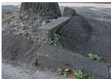
根上がりにより破損する歩道
