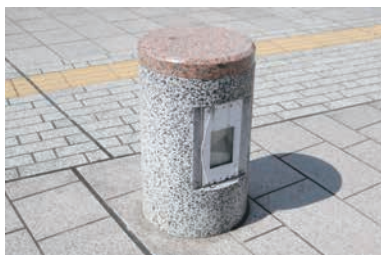
破損した足元灯
