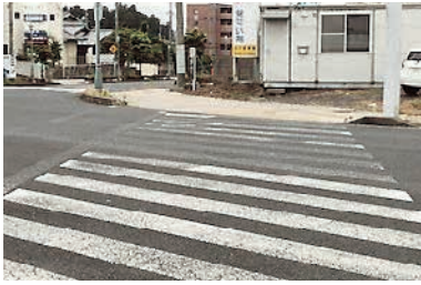
停止線等の補修が必要な道路
