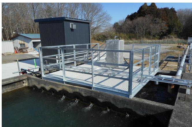
図 4-1-5 活性炭注入設備
