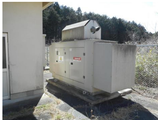
図 4-2-5 内原配水場高区増圧ポンプ 非常用自家発電設備
