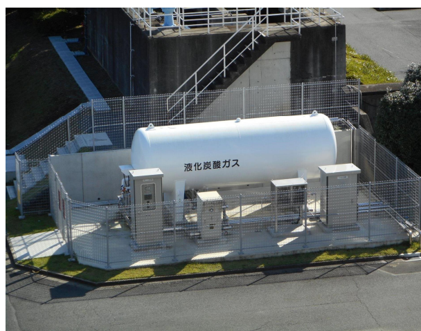
図 4-1-3 炭酸ガス注入設備（楮川浄水場）
