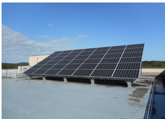
図 4-6-2 栢川浄水場管理棟屋上の太陽光発電装置
