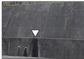
地下水の流出
