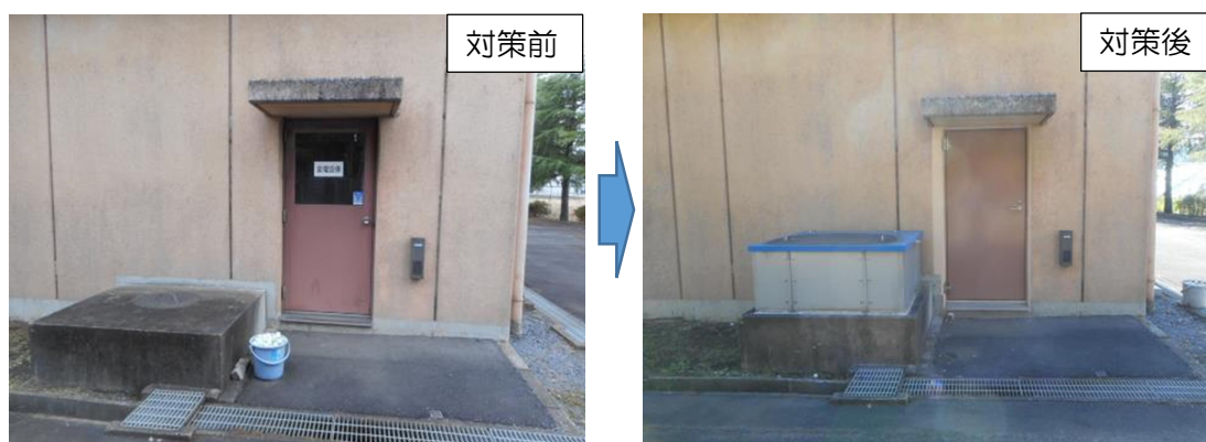
図 4-21 ダム導水ポンプ場 防水扉設置状況及びハンドホール浸水対策状況
