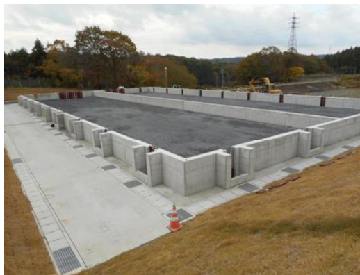
図 4 -29 開江浄水場 天日乾燥床施設設置状況
