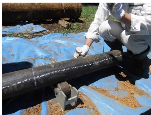
図 3-5 腐食深さ測定状況
