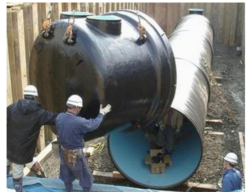
図 4-18 耐震型循環式飲料水貯水槽設置状況
