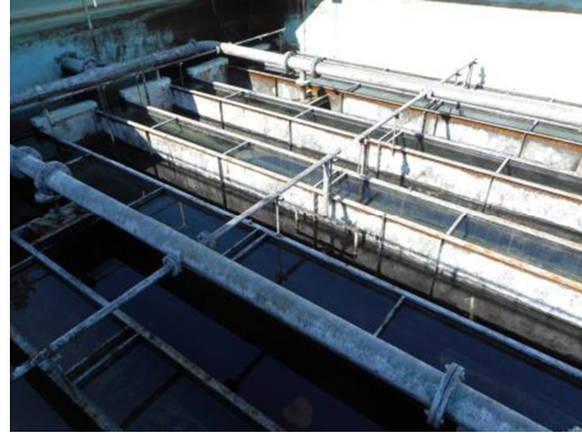
図 4-8 開江浄水場ろ過池腐食進行状況
