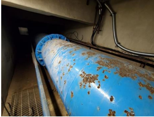
図 4-7 開江浄水場送水管（集合管） 腐食進行状況
