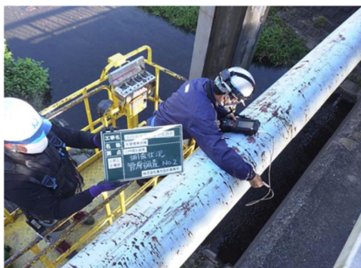
図 3-9 水管橋点検状況・腐食状況
