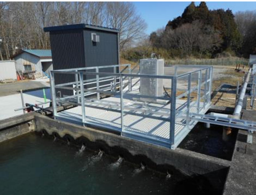
図 4-25 開江浄水場 粉末活性炭注入設備設置状況
