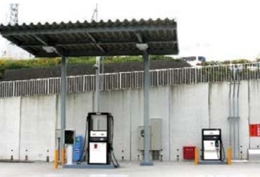
自家用給油所(日立市)
