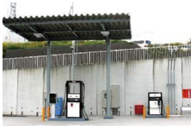
自家用給油所(日立市)
