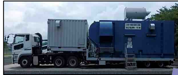
常設代替高圧電源装置 (高圧電源車)
