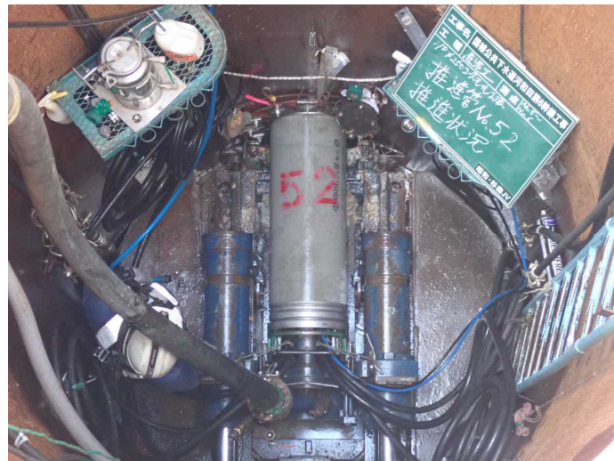
No.10 昭和・杉森JV 国補公共下水道河和田第6幹線工事
