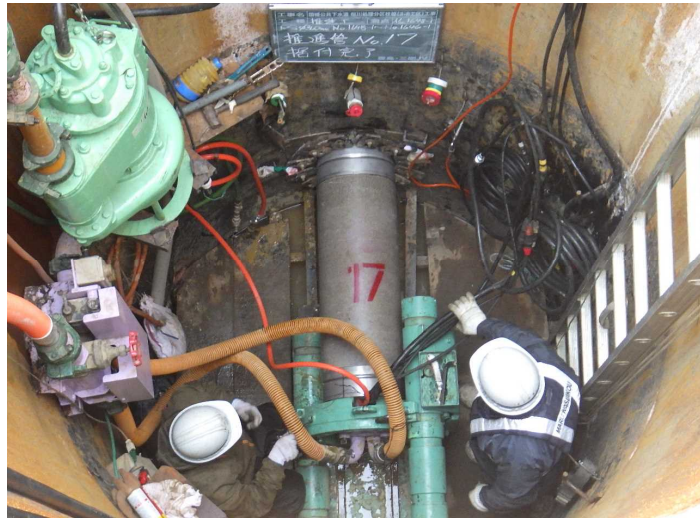
No.21 豊島・三剛JV 国補公共下水道桜川処理分区枝線(3-6工区)工事
