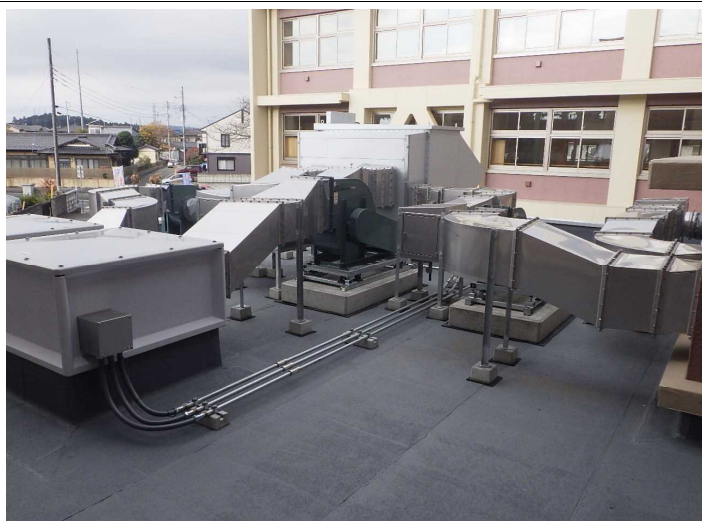
No.11 (株)新栄設備工業 水戸市立渡里小学校長寿命化改良機械設備(空調)工事
