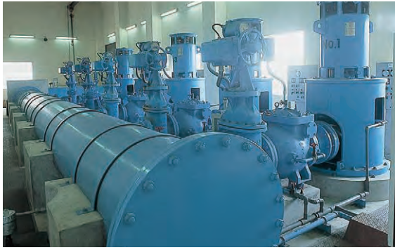
水を送るためのポンプ
