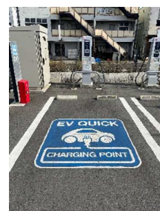
電気自動車用 急速充電設備
