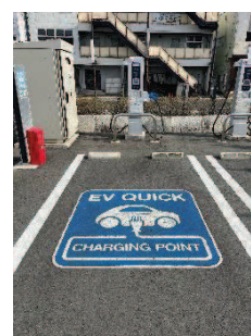
電気自動車用 急速充電設備
