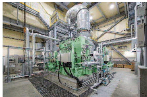
蒸気タービン発電機
