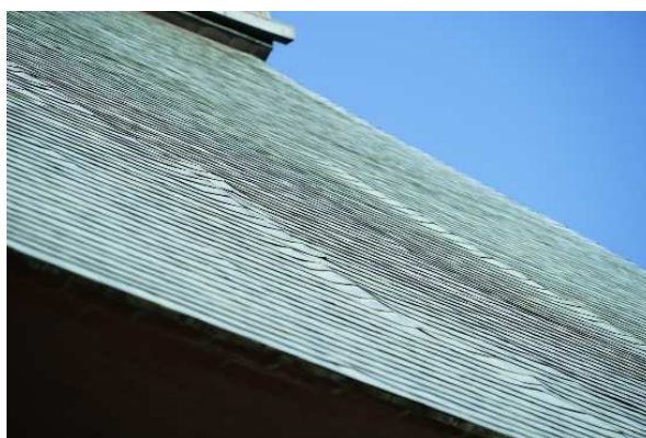
屋根銅板の歪み
