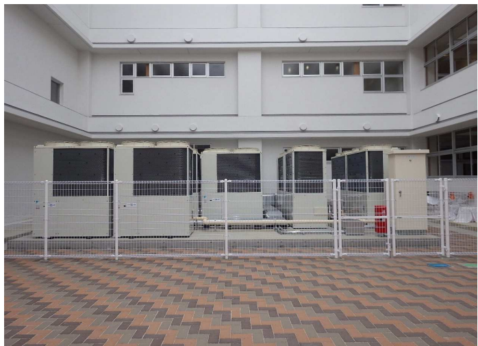
No.7 菊地・小河原JV 水戸市立見川小学校増改築機械設備(空調)工事
