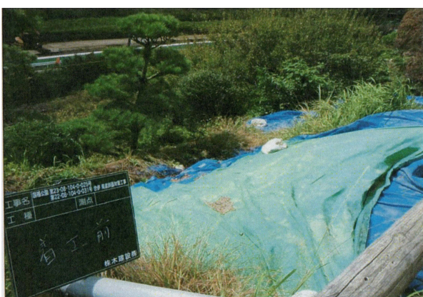
南崖地割れ② 着工前
