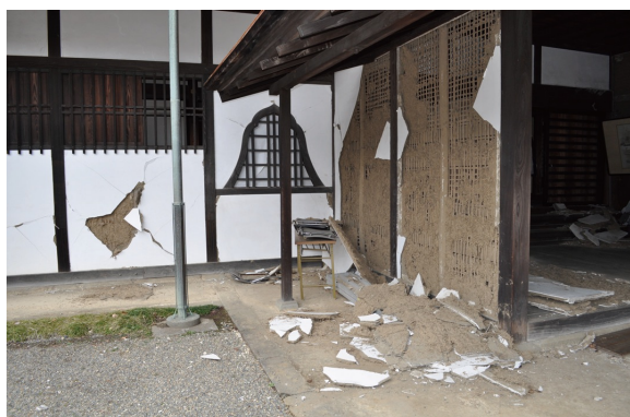
正庁玄関崩落状況 ①
