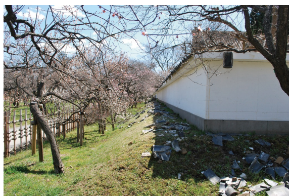
築地塀瓦落下状況
