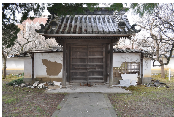
孔子廟戟門破損状況
