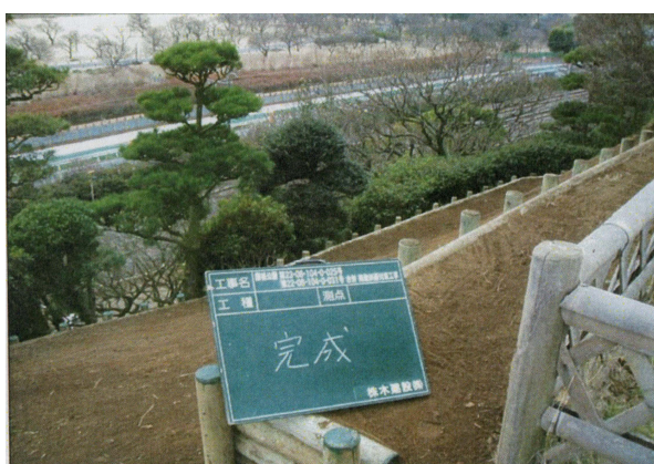
南崖地割れ② 竣工後
