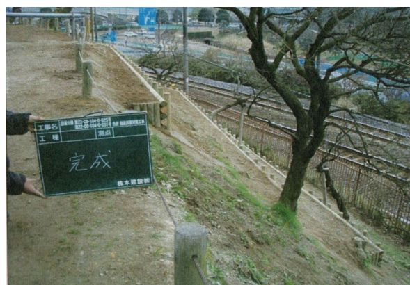
南崖地割れ① 竣工後
