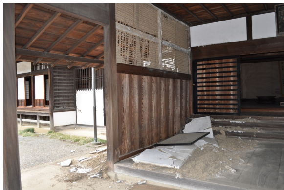
正庁玄関崩落状況 ②
