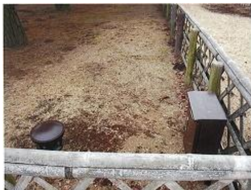
①防災設備(半埋型スピーカー)設置状況写真
