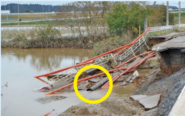
破断した水道管
