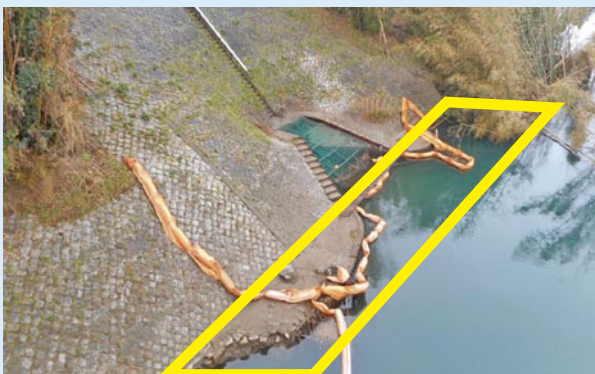
崩れ落ちた護岸
