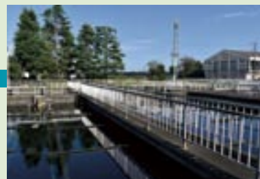
最終沈でん池
