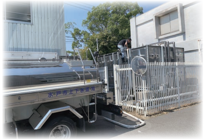
受水槽へ給水している様子
