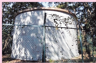
最高区配水池 水戸市の配水池の中で、一番 高いところにあり、開江浄水 場より高い地区に配水してい ます。 有効容量:154m 3
