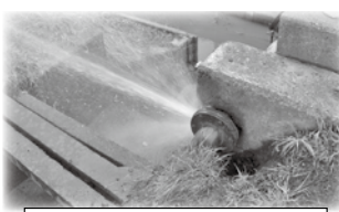
添架管の漏水
