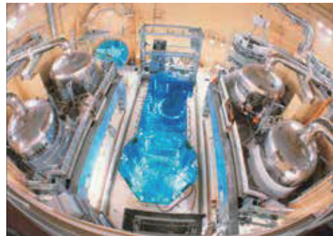
原電敦賀2号機（PWR）蒸気発生器
