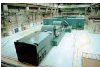
タービン発電機
