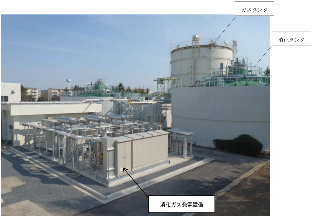
写真-1 消化ガス発電設備 現況
