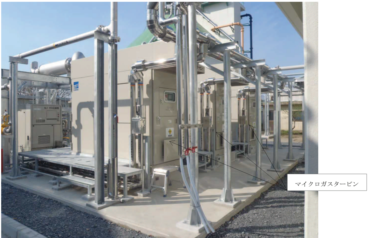
写真-2 マイクロガスタービン3台
