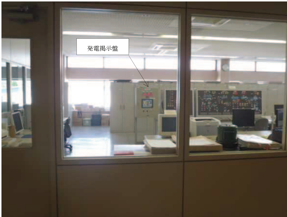
写真-3 中央操作室 発電揭示盤
