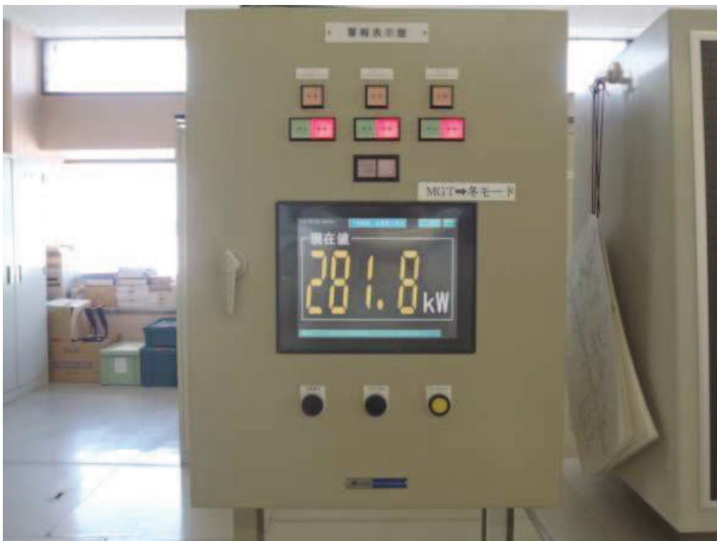
写真-4 発電状況 揭示盤
